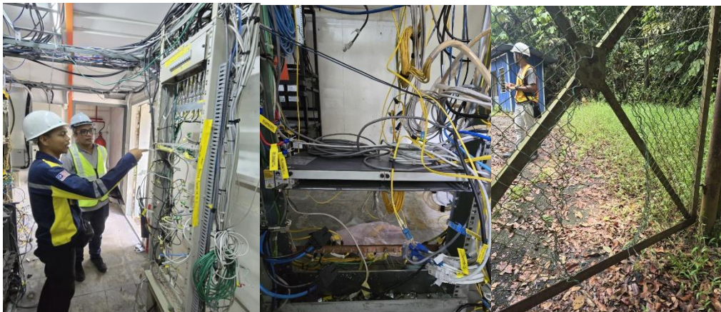
Perbuatan vandalisme oleh pihak tidak bertanggungjawab ke atas menara komunikasi di Bukit Pilah, Negeri Sembilan.
