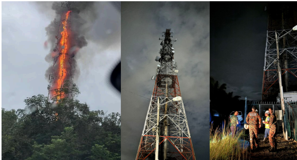
Menara telekomunikasi terbakar di lokasi Kampung Kelebor, Kuala Kangsar, Perak.
